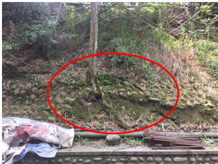
圖 3-4 既有漿砌卵石護坡老舊，又遭樹木根系擠壓破壞
